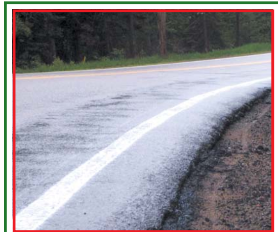
Dénivellation entre chaussée et accotement
