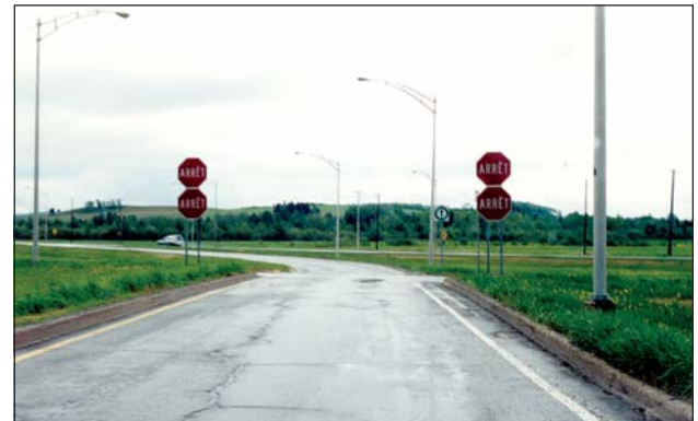
Une géométrie inhabituelle à un croisement de route requiert une signalisation excessive.
