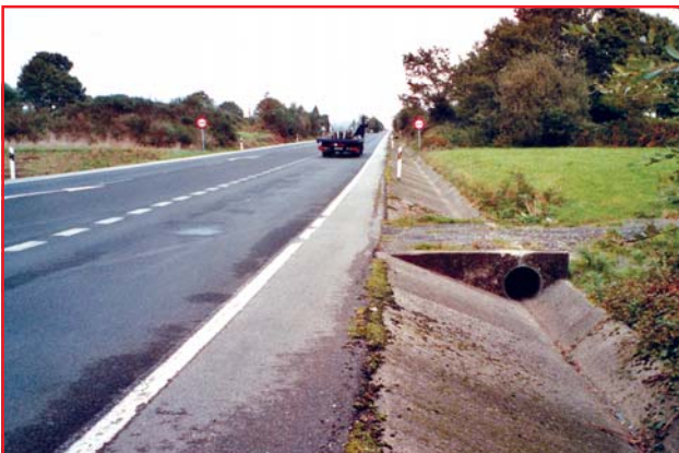
Structure de drainage hasardeuse sur une artère rurale. (l'usager de la route qui déborde sur l'accotement peut être dirigé vers une structure verticale en béton.)
