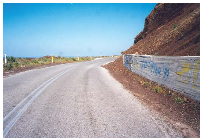
Débris sur la chaussée - Le mur de soutènement est trop court
